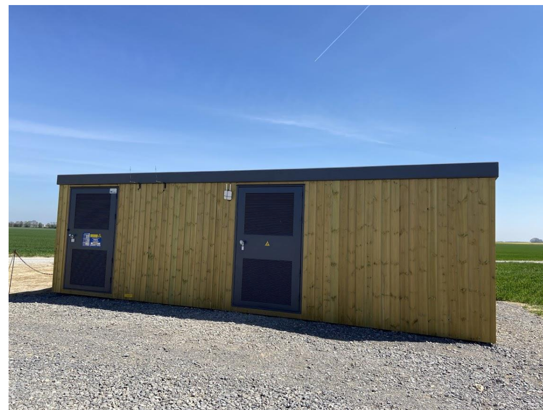
Poste de livraison du parc éolien du SOMMEREUX (60)
