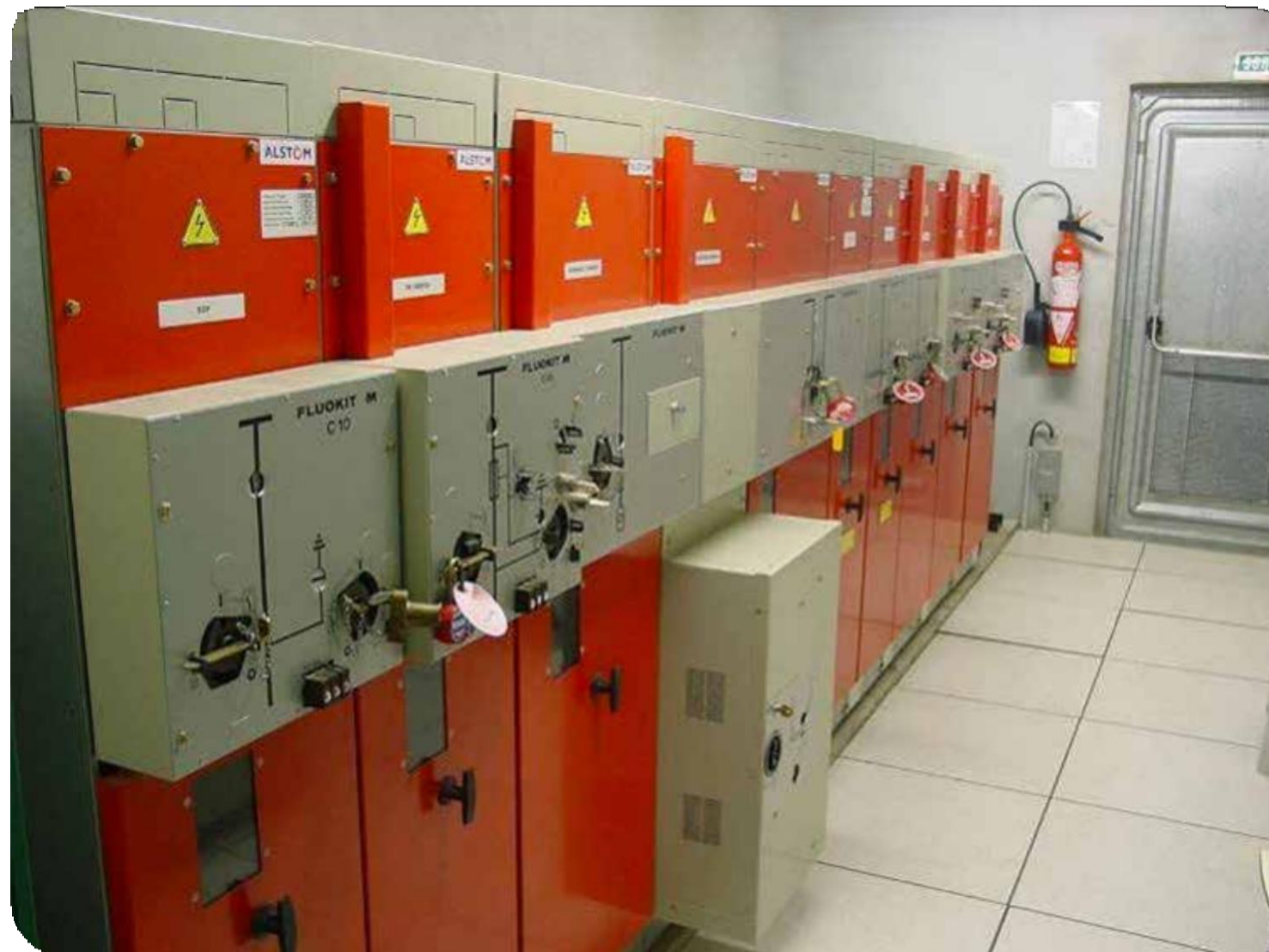
Intérieur d'un poste de livraison
